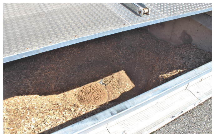
Photo 24. Silo de la chaufferie bois du Service départemental d'incendie et de secours (SDIS) à La Saulce (© Communes forestières Provence-Alpes-Côte d'Azur).
