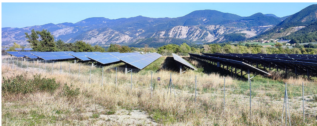
Photo 25. Parc photovoltaïque, Vitrolles (© GeographR).
